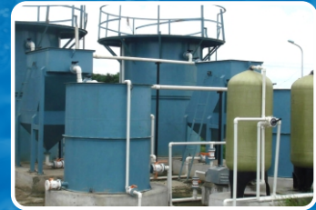
EFFLUENT TREATMENT PLANT(ETP)
